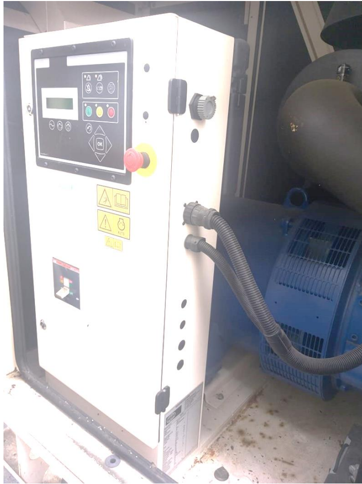
Figura 9. Tablero de Operaciones de Motores Eléctricos de Inducción Fuente: (EMSABA EP, 2018)
