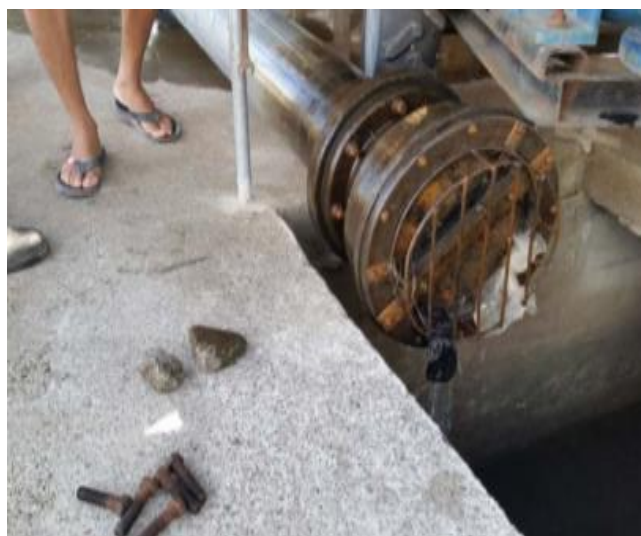
Figura 6. Mantenimiento de Absorbente Bomba EMELRIOS Fuente: (EMSABA EP, 2018)
