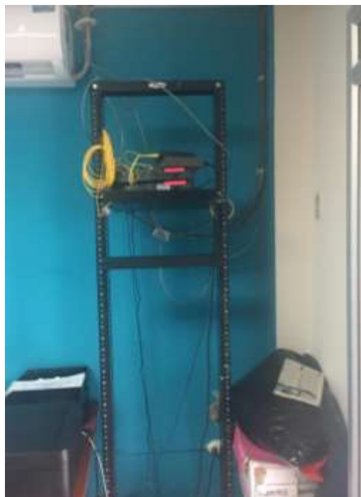
Foto 1. Estado de los equipos de red del GAD de Pimocha. Autor - (Moreno, 2020)
