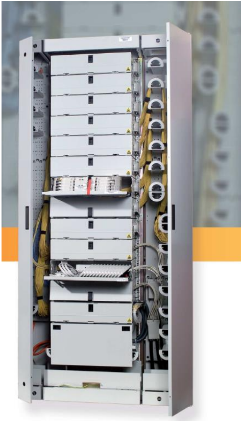
FIGURA 7. ODF para planta interna y plana externa. FUENTE: documento de capacitación CNT 12-05-2014.
