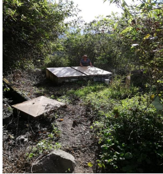
Foto 5.- Cajas rompe presión.
