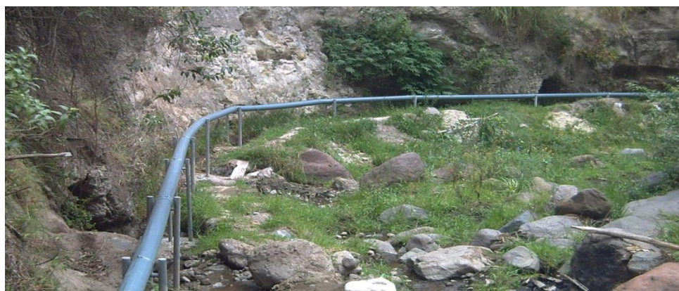
Imagen 2 Tubería de conducción principal del sistema de riego, evaluación del sistema de riego La Chimba, comunidad la Portada, cantón Mira, provincia de Carchi UTB, FACIAG, 2019
