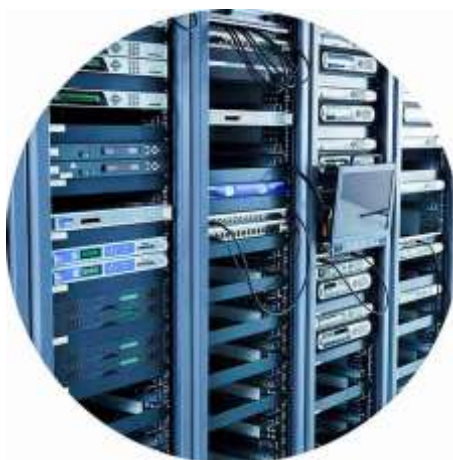
Grafico 2 Racks repletos de servidores, siempre en ambientes refrigerados e ignífugos Fuente: Duplika.com
