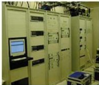
Equipamiento del hub
