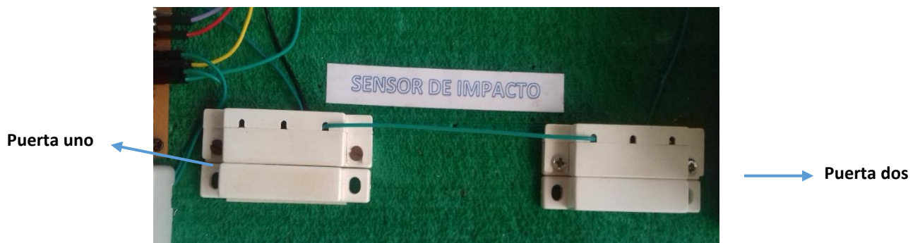
Ilustración 35 - Instalación de sensores magnéticos
