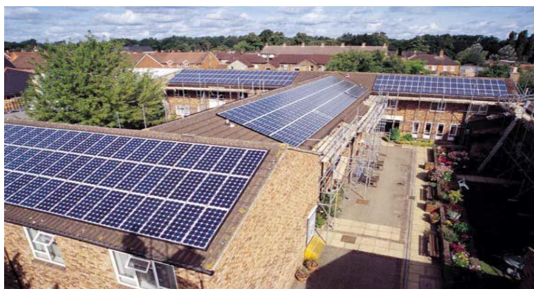
Figura 4: FV en un tejado inclinado (UK)
