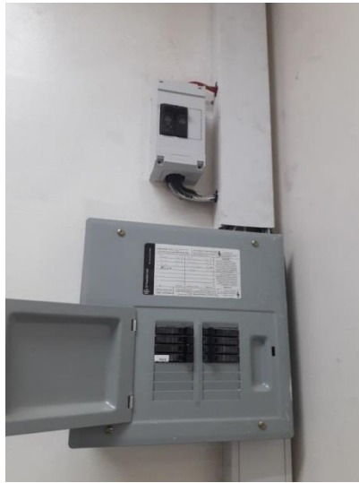
Distribución y caja de breques de corriente
