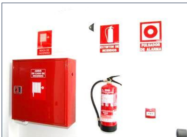
IMAGEN N°6: Señalización de equipos de emergencia
