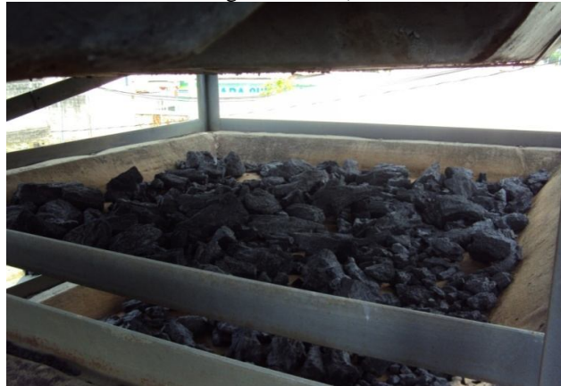
Figura 5. Carbón activado en bandejas de torre de aireación (Planta de Tratamiento de agua de Baba)
