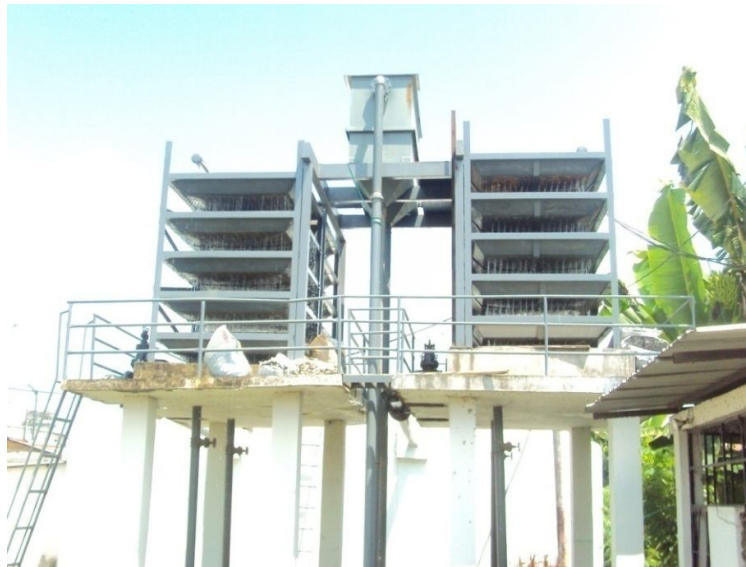
Figura 3. Torres de aireación de Planta de Tratamiento de Baba
