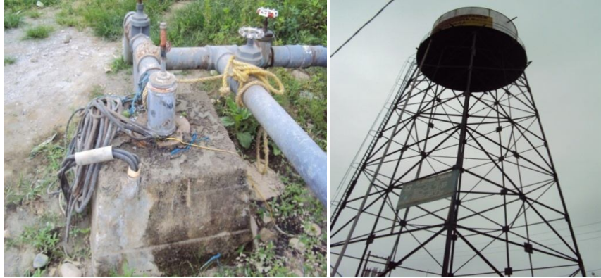
Fig. 1 Pozo y Fig. 2 Tanque elevado de la planta de tratamiento de agua de Baba
