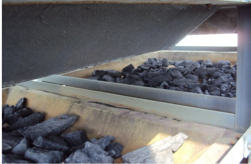
Figura 4. Carbón activado en bandejas de torre de aireación (Planta de Tratamiento de agua de Baba)
