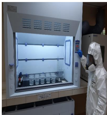
Figura 12. Campana extractora de gases
